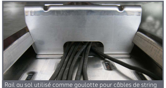
Rail au sol utilisé comme goutte pour câbles de string
