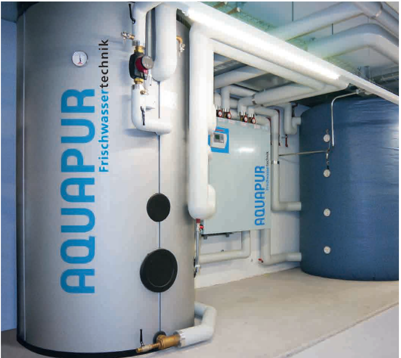
Objekt: Sporthalle Lücken, Schwyz Planer: Otmar Spescha, Schwyz Ausführung: Reichmuth Heizung Sanitär, Schwyz
