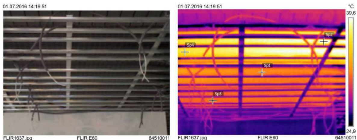
Fig. 1 – Exemple de contrôle à la caméra thermique avant la pose des plaques de faux-plafond
