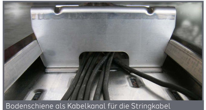
Bodenschiene als Kabelkanal für die Stringkabel
