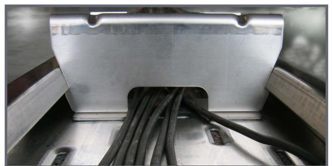
Bodenschiene als Kabelkanal für die Stringkabel genutzt
