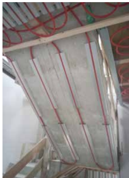
Einfamilienhaus mit Klimadecke bis ins offene Treppenhaus.
