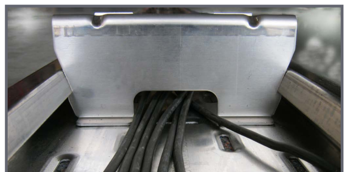
Bodenschiene als Kabelkanal für die Stringkabel genutzt
